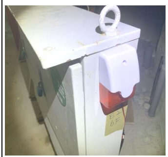
說明:配電盤電箱蜂鳴器
